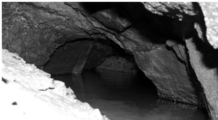
Rys. 10. Zawal w części południowej wyrobiska
