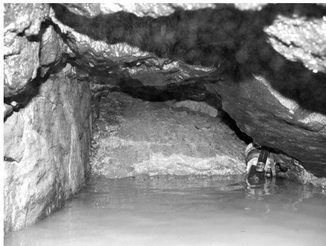
Rys. 9. Zawał w części północnej wyrobiska Fig. 9. Wear out corridor in north adit
