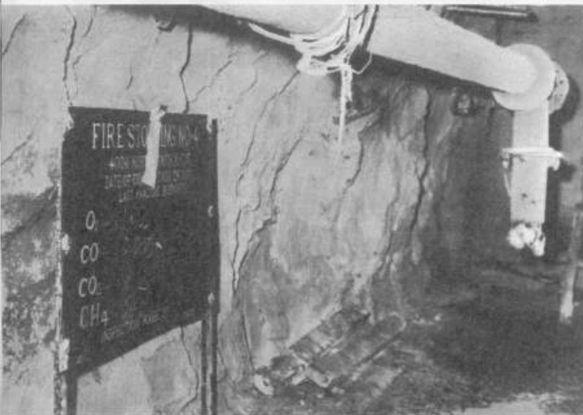
Jedna ze ścian, którymi Polacy odizolowali pole pożarowe od pozostałych wyrobisk (zdj. z archiwum inż. Bieska)
