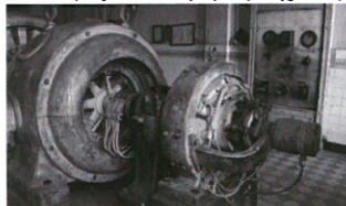
Przetwornica prądu maszyny wyciągowej.
